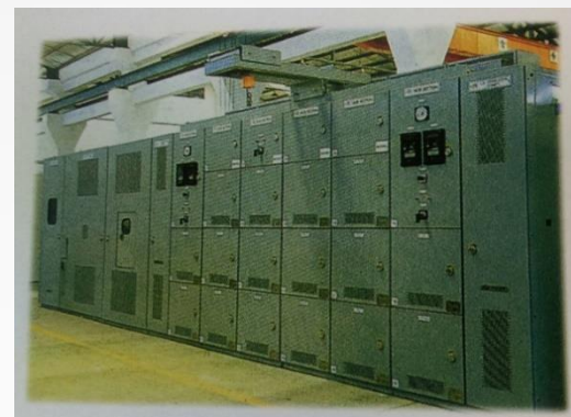
480V電力配電中心(Power Center)
